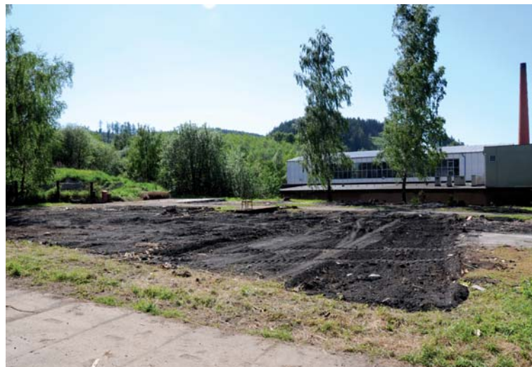
Na místě starých dřevěných budov se začaly budovat základy příštího parkoviště pro vozy servisu, MTZ a IT.
