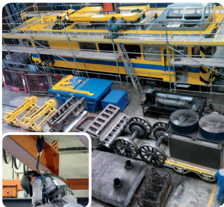
Investice do BOZP se zaměřují na práci ve výškách, na nákup lešení a vázacích systémů.
