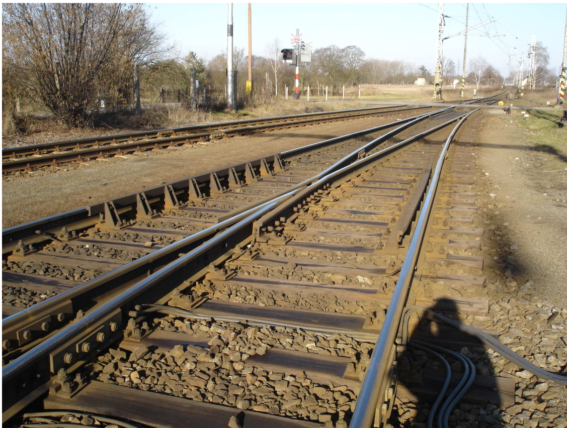
Obr.3 Pohled na začátek hradeckého zhlaví, na výhybku č. 6 umožňující přechod z koleje č. 1 na kolej č. 2 a srdcovku s viditelně pojižděnými hranami.
