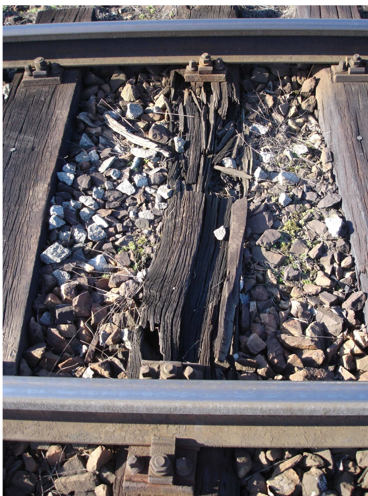
Obr.18 Rozpadlý pražec na koleji č. 2
