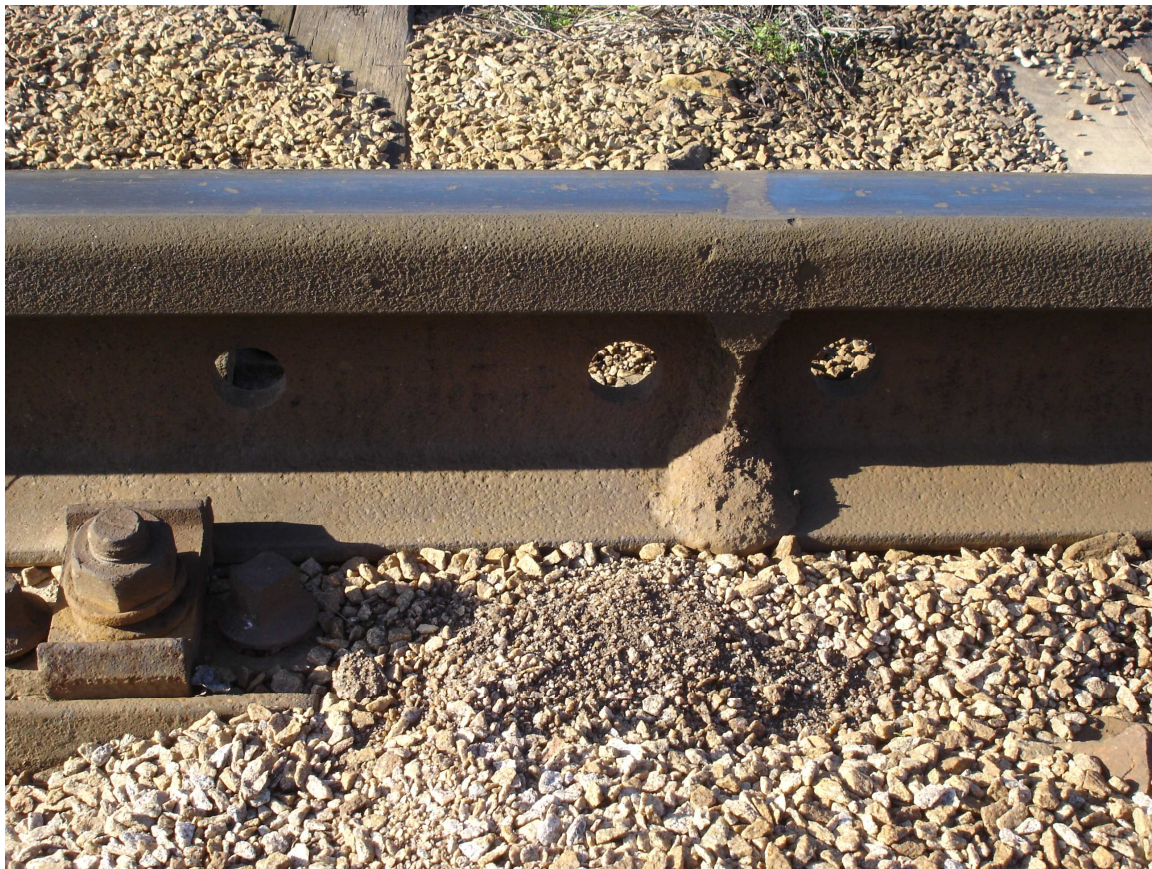
Obr.16 Dříve stykovaná kolej, dnes bezstyková opatřená termitovým svarem.
