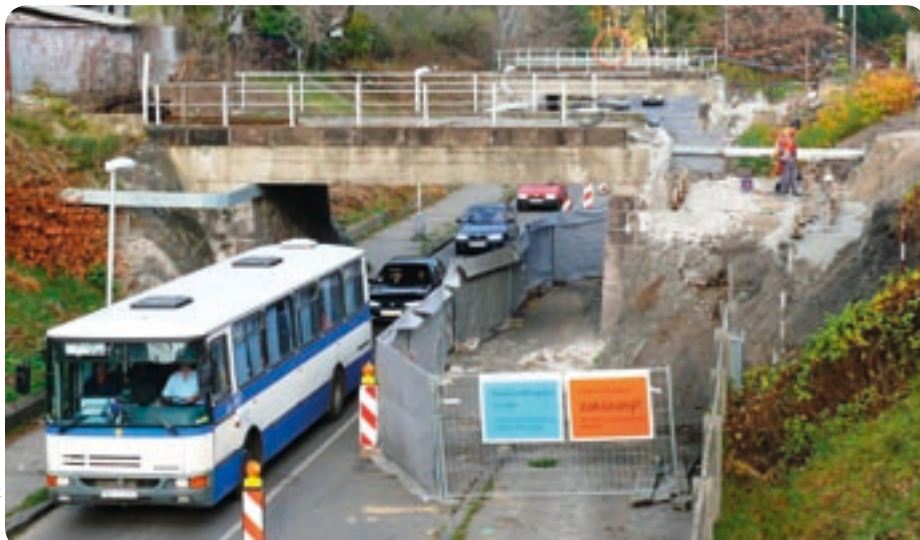
Okrem 6-dňovej výluky traťovej koľaje ovplyvňuje dopravu v Železničnej stanici Nové Zámky aj dlhodobá úprava dvoch mostov pred vstupom do depa, na štúrovskom zhlaví stanice. Firma Skanska buduje v ich oporných pilieroch podchody pre peších aj cyklistov. – Keďže sme silná vlakovotvorná stanica, museli sme vyriešiť výjazdy hnacích vozidiel z depa. Cestujúci si tento dočasný stav ani nevnímajú, vlaky kvôli tomu nemeškajú. – pochválil dopravnú situáciu v stanici jej prednosta Ing. Ján Kasaš.
