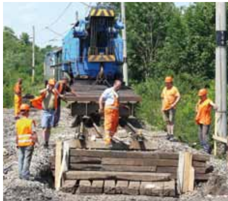
Ešte posledná kontrola krajnej opory z podvalových rovnánin a mostné provizórium sa môže uložiť.
