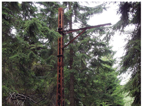
Druhý ze dvou zachovaných stožárů trakčního vedení z roku 1927 na našem území, Harrachov, 18. 8. 2007, © Zbyněk Zlinský
